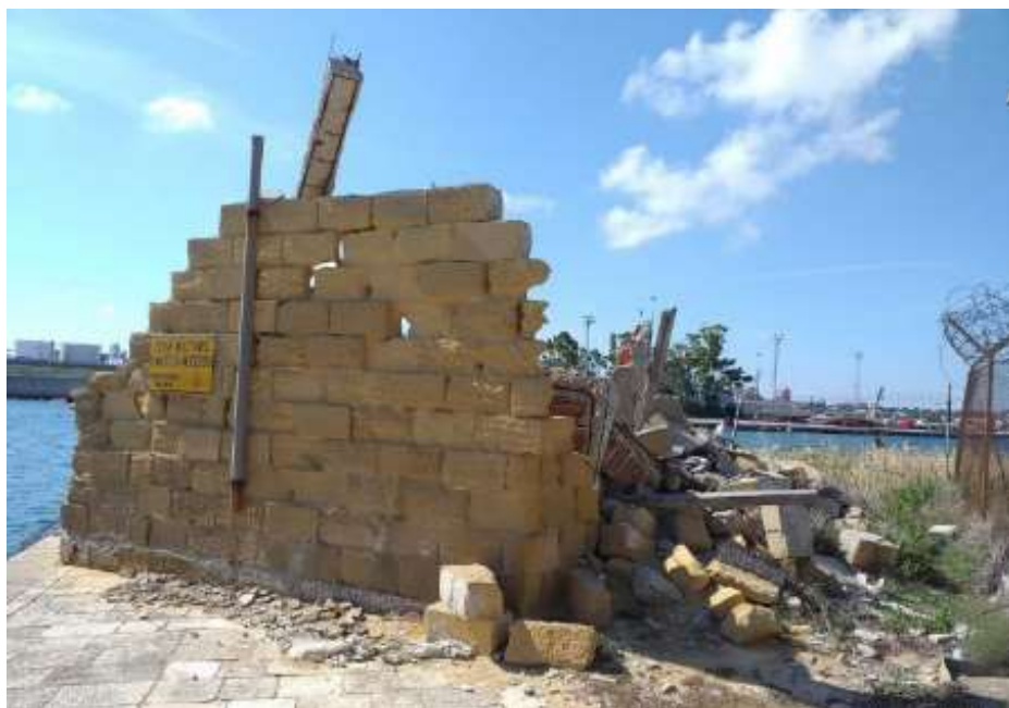
Struttura muraria di copertura collassata, 16 giugno 2021 (foto archivio Italia Nostra APS)
