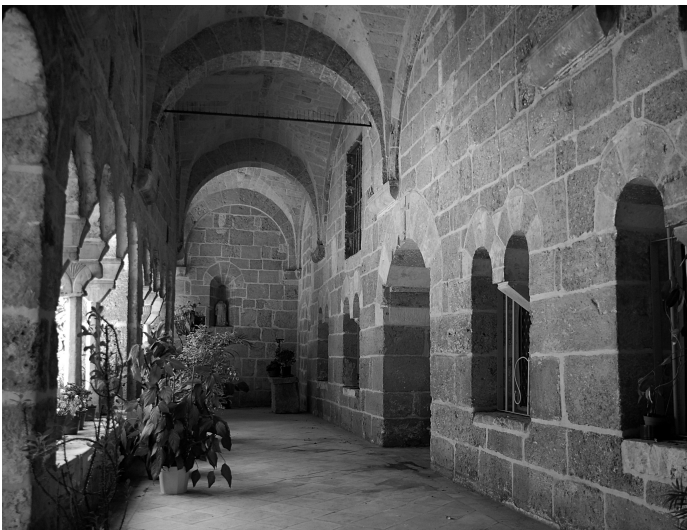
Fig. 22. Brindisi, monastero di S. Benedetto. Lato Est del chiostro, prospetto di età bizantina.
